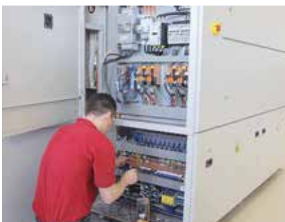
Frei zugänglicher Schaltschrank
